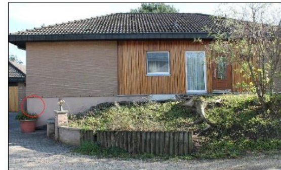
Abbildung 3.1-a: Fassade Nord – Riss im Eckbereich (siehe Abbildung 3.1-b)
