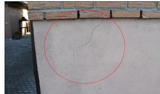
Abbildung 3.1-b: Fassade Nord – Riss im Eckbereich (0,6mm)
